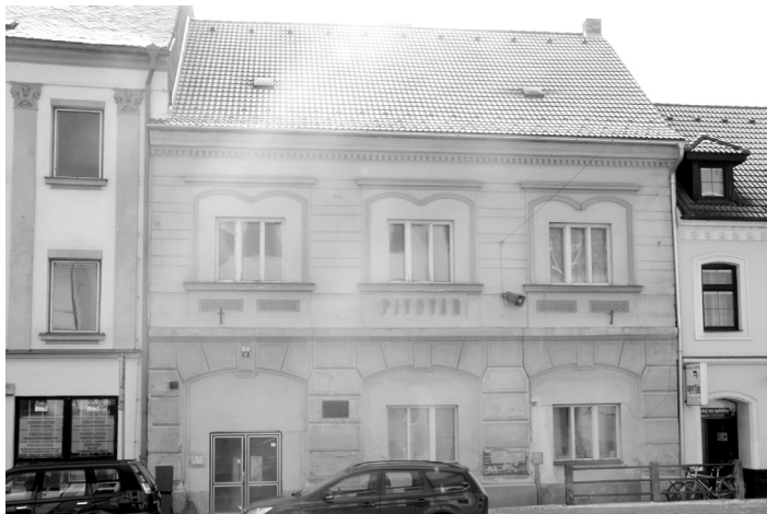
Fasáda domu čp. 47, který býval měšťanským pivovarem a nacházela se zde hospoda zvaná Beseda, čeká na opravu. Foto: Archiv MěÚ
