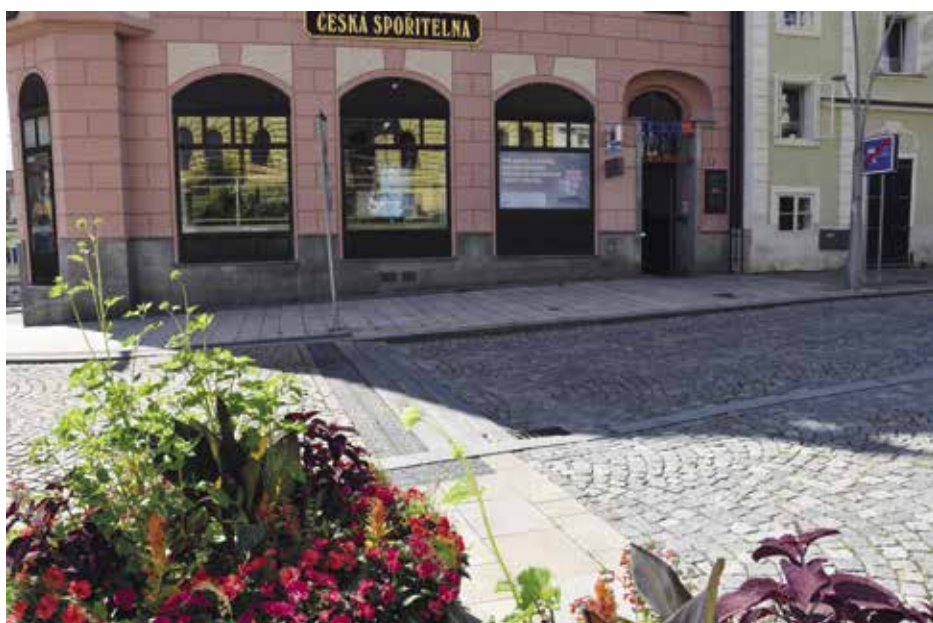
Třístupňový práh před opravou
